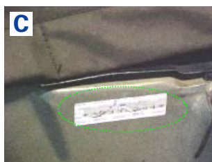
Painel de corta fogo, lado direito
